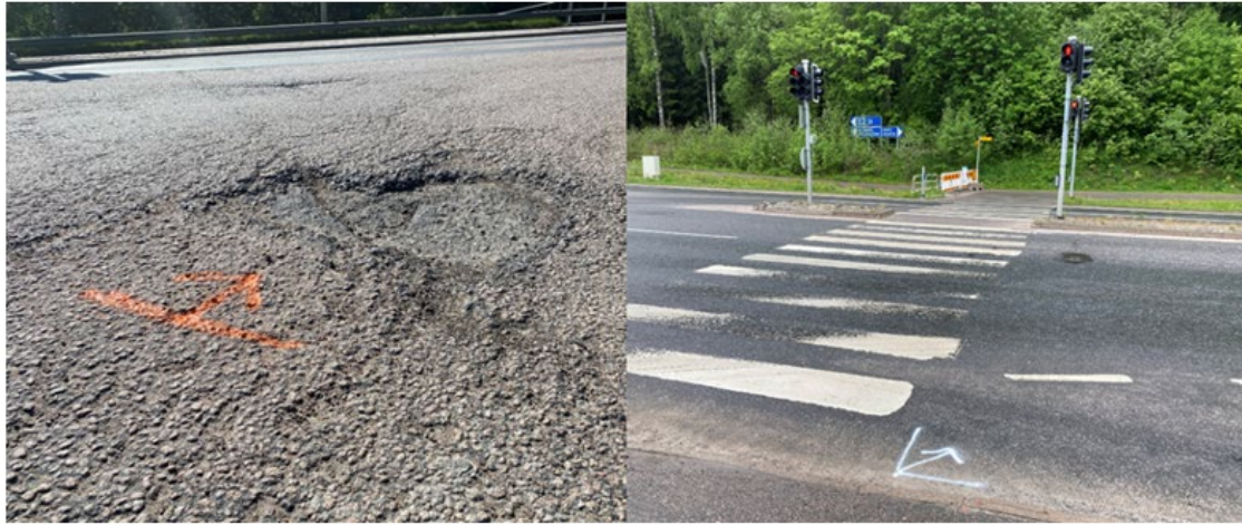
Kuva 5. Kohdekatselmuksessa tarkennettuja aloitus- ja lopetuskohtia. Vasemmalla kuvassa käsiteltävä alue on tarkennettu ulottumaan havaitun vauriokohdan yli. Oikealla kuvassa käsiteltävä alue on tarkennettu suojatien reunaan. (valokuvat: Alina Koskinen)
