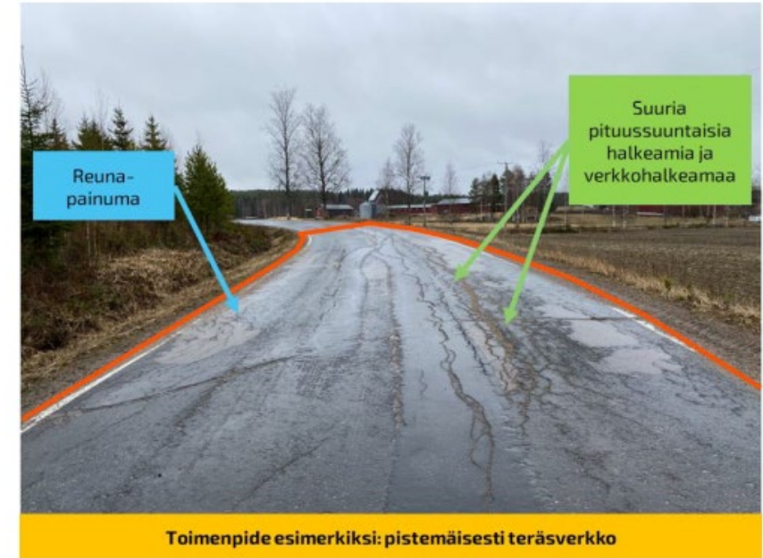
Kuva 21. Vaurioina on lyhyellä osuudella reunapainumaa ja suuria pituussuuntaisia halkeamia. Toimenpide on esimerkiksi teräsverkko merkitylle osuudelle. (valokuva: Niko Väättäinen)
