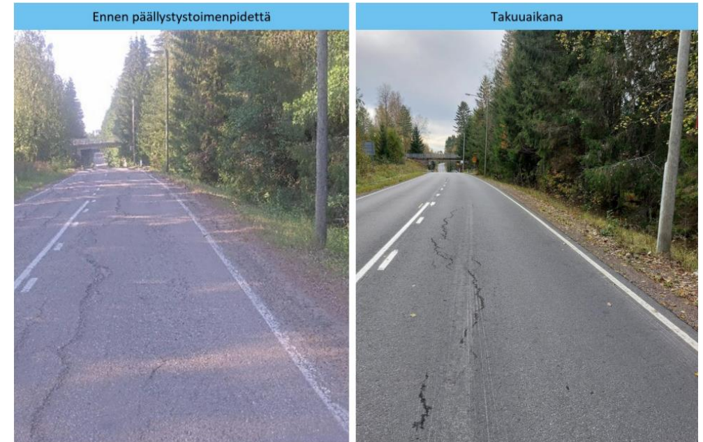
Kuva 23. Esimerkki lähtötilanteen havaintojen vertaamisesta takuuajan havaintoihin. Vasemmalla on kuva kohteesta ennen päällystystoimenpidettä (Valokuva: Tiekuva) ja oikealla kuva takuuajana kohdalla havaitusta halkeamasta (Valokuva: Anniina Tuomala).
