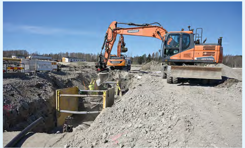
Kaivantojen reunat on stabiloitu ja lisäksi käytetään tuentaelementtejä, jotta työ voidaan tehdä turvallisesti.
