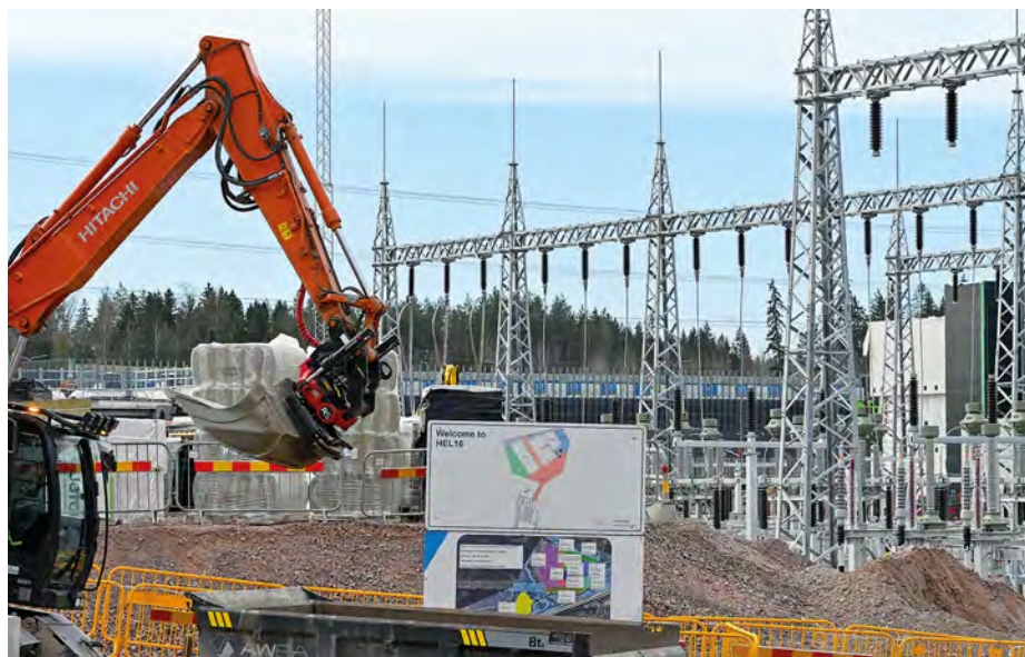
Datakeskuskokonaisuus muodostuu useista erillisistä serverihalleista sekä niitä tukevista sähkö-, jäähditys- ja teknisistä rakennuksista, kuten sähköasemista ja varavoimajärjestelmistä.
